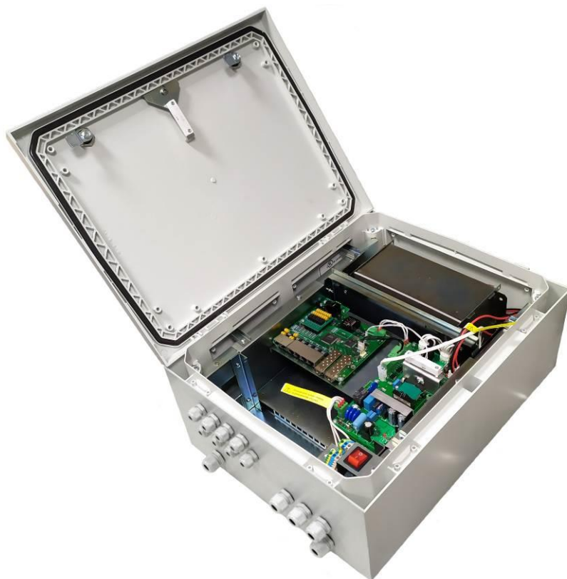
Рисунок 3.1.2 - PSW-2G6F+UPS-Box - вид внутри
